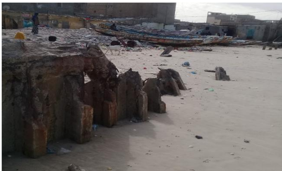
Image 1 : Délabrement du mur colonial de protection contre l'avancée de la mer
