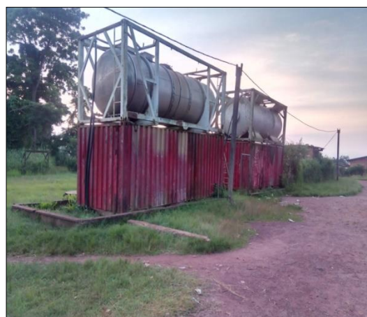
Photo 5. Cuves alimentant les fontaines en eau potable Prise de vues. G.R. MOUANDA NIAMBA, juin 2022
